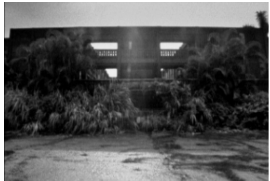
圖 3-12：聯福製衣廠女工宿舍廢墟
